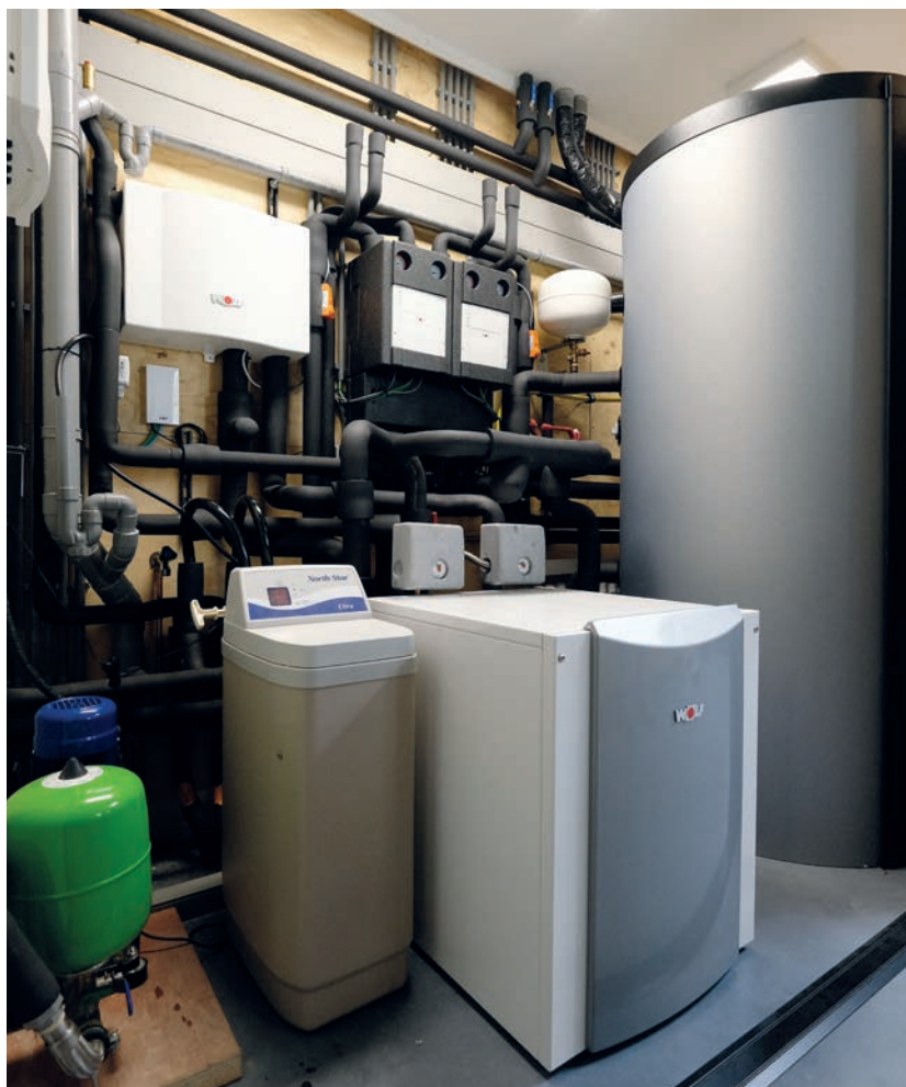
Wolf bodemwarmtepomp BWS-1-06. Ook te zien op de foto een North Star waterontharder en een Duivelaar drukverhoger.
